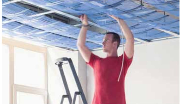
Kapillarrohrsystem von GeoClimaDesign als Deckenheizung und -kühlung
